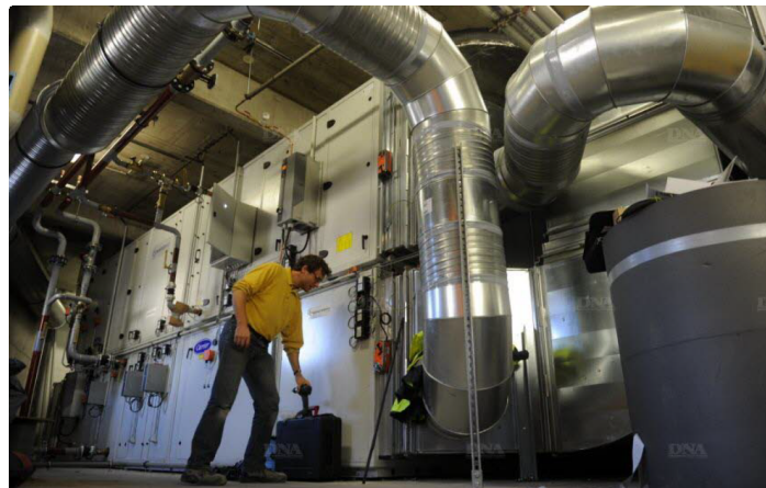
Vue de la centrale de traitement d'air labellisée NTE
