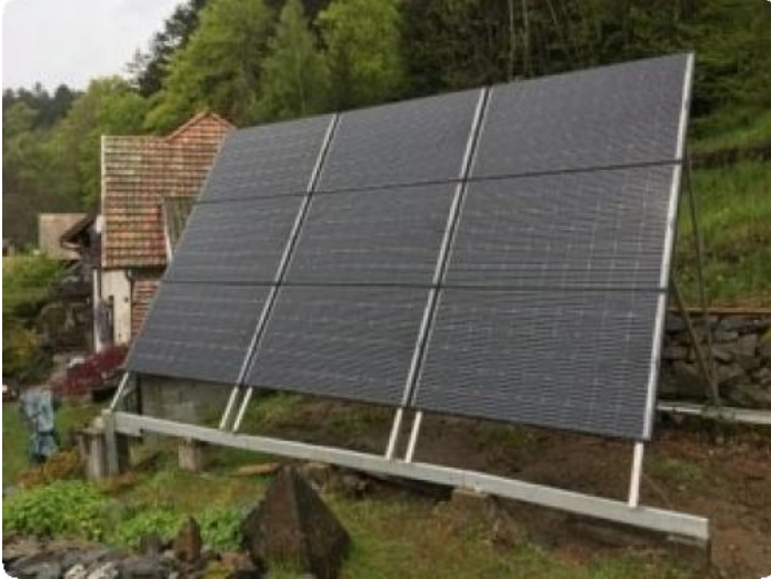
Installation solaire à Linthal (68)
