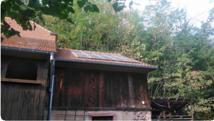
Installation solaire au rucher d'Altenholz
