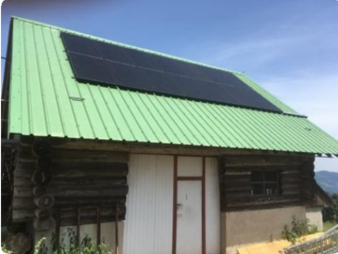
Installation solaire au Gsang
