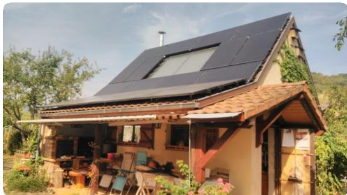
Installation solaire à Bergheim (67)
